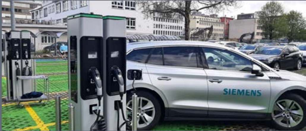
Der Ausbau der E-Ladestationen an den Siemens-Standorten geht laufend weiter.
